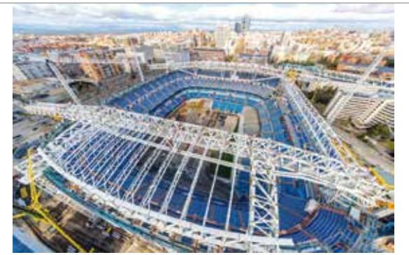
Ein Blick hinein in die königliche Arena, auch im Innenbereich eine komplette Baustelle.
