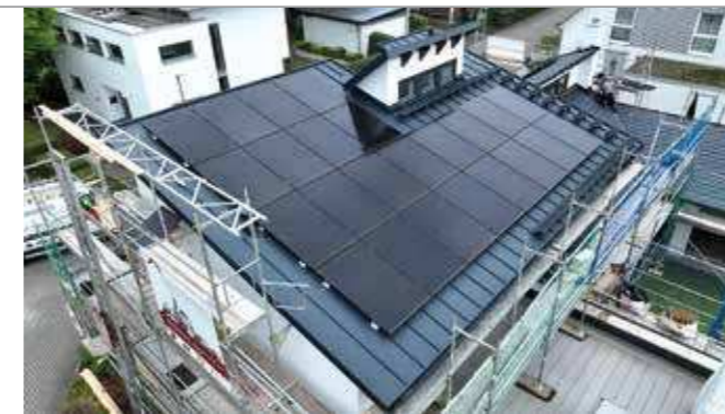
Eine PV-Anlage ist Bestandteil der neuen Dachlandschaft.
