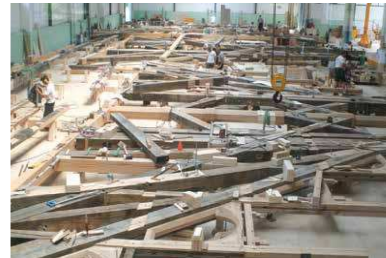
Auf Abbundböcken liegen die Balken für den Abbund über dem 1:1 Aufriss des Spitzturmes.
